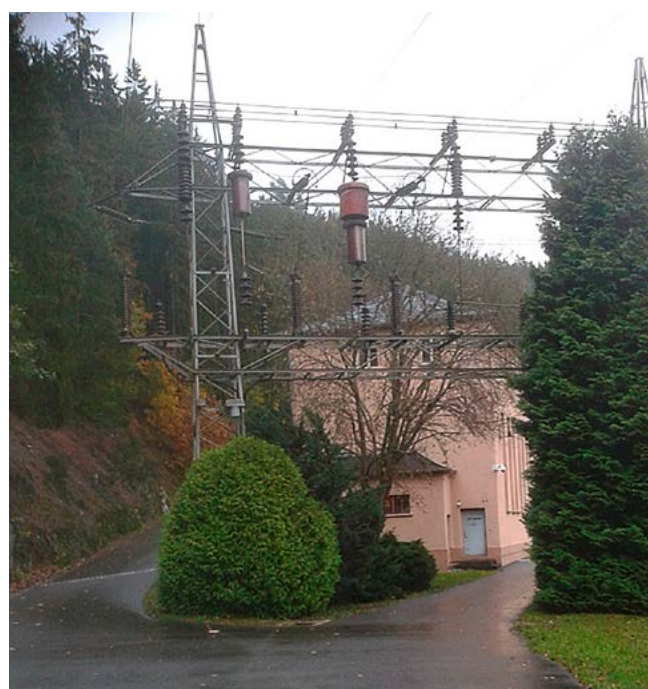
Bild 19: Umspannwerk Wisenta, TFH
