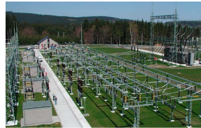
Bild 83: UW Altenfeld, 380/110 kV (VEAG, jetzt 50Hertz) und 110/20/15 kV (TEN)
