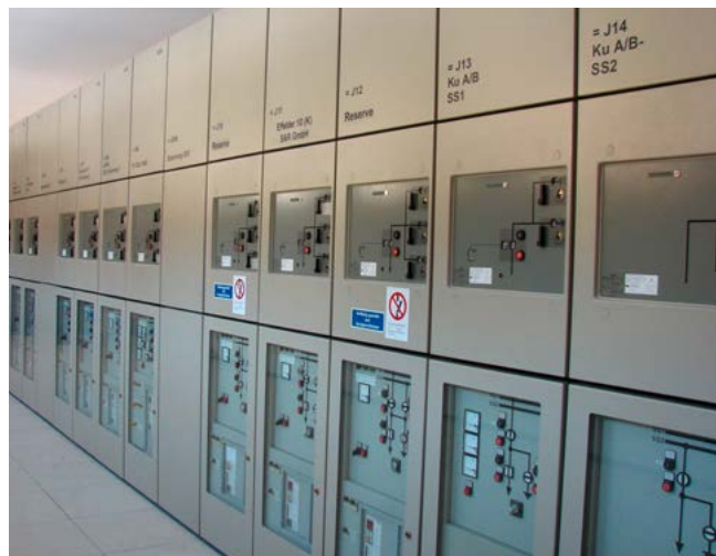
Bild 82: UW Mürschnitz, 20-kV-Schaltanlage
