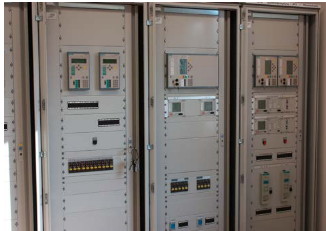
Bild 76: 110-kV-Schutz- und Steuerschränke, links Transformator-Differenzialschutz 7UT6 mit UMZ-Schutz 7SJ6, Siemens, Mitte Feldleitgerät, Verstimmungsgradregelung, REG-DP, A. Eberle, und MS-Erdschlusserfassung, UEw01, EAW, rechts Feldleitgeräte, SIEMENS, Spannungsregler, REG-D, A. Eberle, AFE-Relais, 7RW600, Siemens sowie die jeweils zugehörigen Prüfsteckdosen, IPS, SecuControl und Zwischenrelais, 2RH02, EAW
