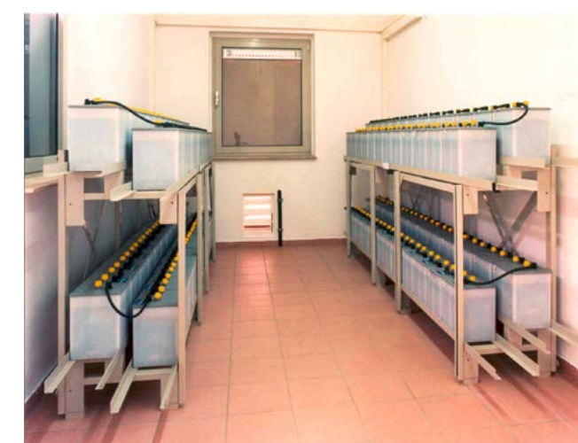
Bild 73: Einsatz von zwei Batterieanlagen
