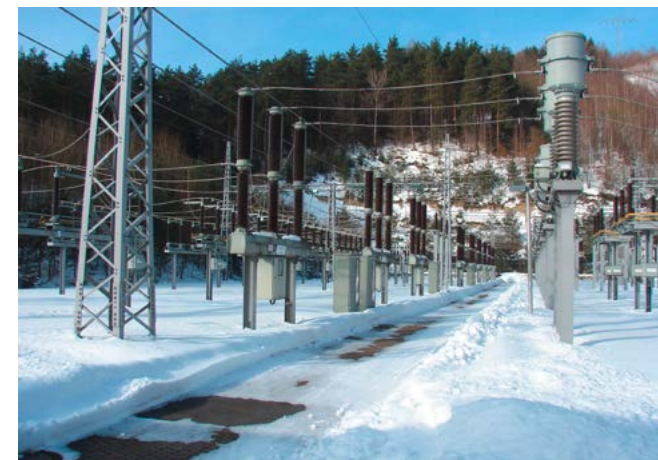
Bild 81: UW Mürschnitz 110-kV-Anlage
