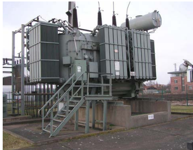
Bild 44: Trafo 103 im UW Gotha/Gleichenstraße
