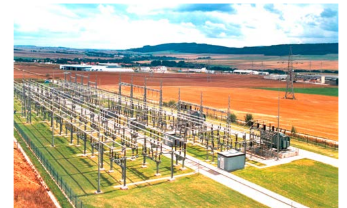
Bild 79: UW Eisenach, 110-kV-Anlage
