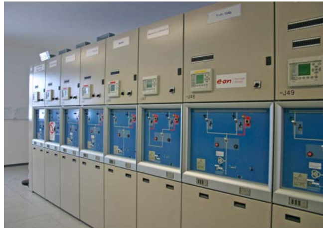
Bild 75: 20-kV-Schaltanlage WSB mit Distanzschutz und Steuerung, P439, AREVA und Prüfsteckdose, IPS, SecuControl
