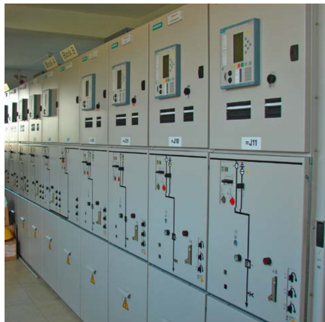
Bild 67: 20-kV-Schaltanlage 8DA10 und Distanzschutz 7SA631 (Siemens) im UW Neuhaus-Schierschnitz
