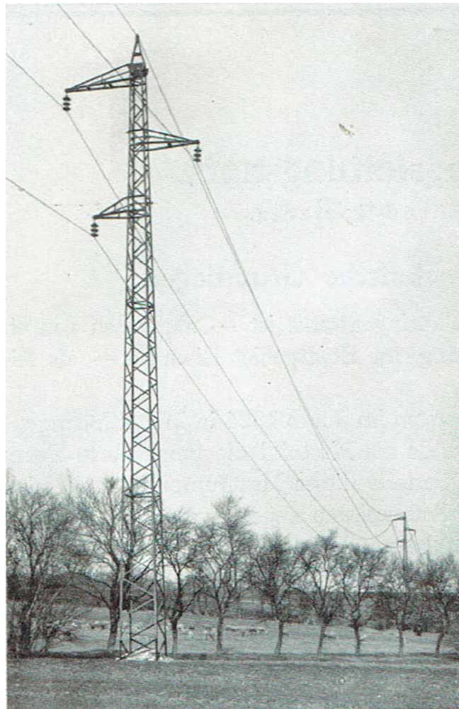
Bild 6: 50-kV-Mast, vorerst nur für ein System ausgebaut
