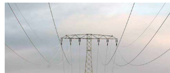
Bild 41: Standard bei den 110-kV-Freileitungen ist die Horizontalbauweise
