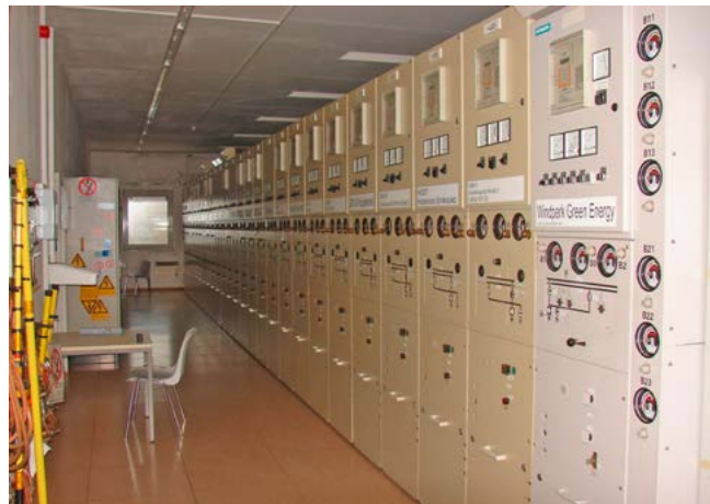
Bild 80: UW Eisenach, 20-kV-Schaltanlage
