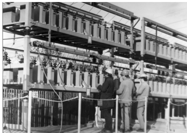
Bild 37: Kondensatorenanlage im UW Langensalza
