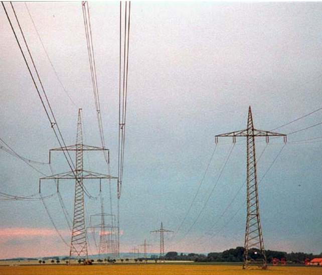
Bild 62: Leitungen der Wiedervereinigung, Nähe Gotha, 380 kV, 50 Hz und Bahnstrom 110 kV, 16 2/3 Hz.
